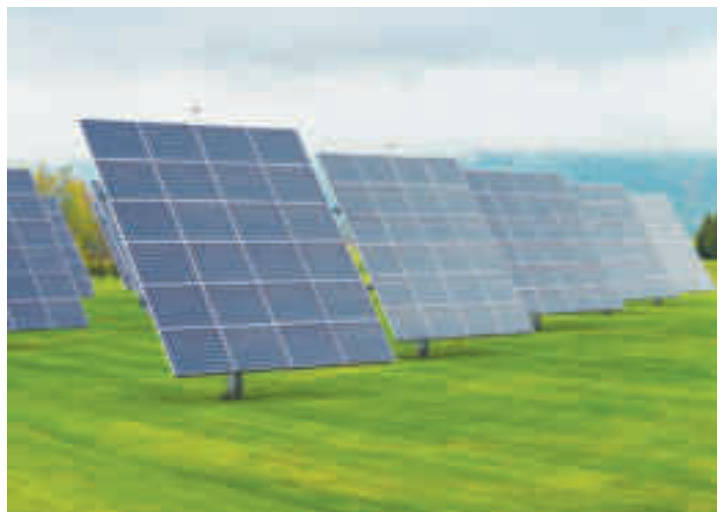
Paneles solares utilizados para aprovechar la energía del sol.
