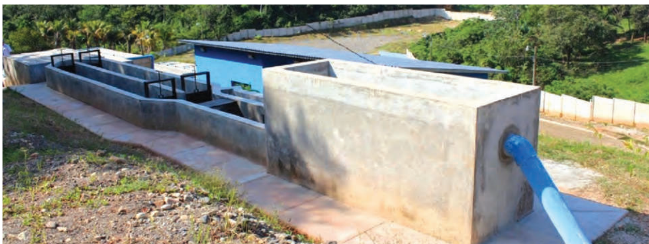
Planta de tratamiento de agua en Trujillo.
