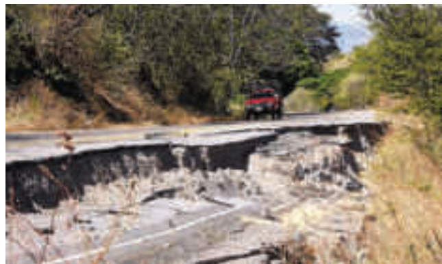
Falla geológica en la carretera al sur, Honduras
