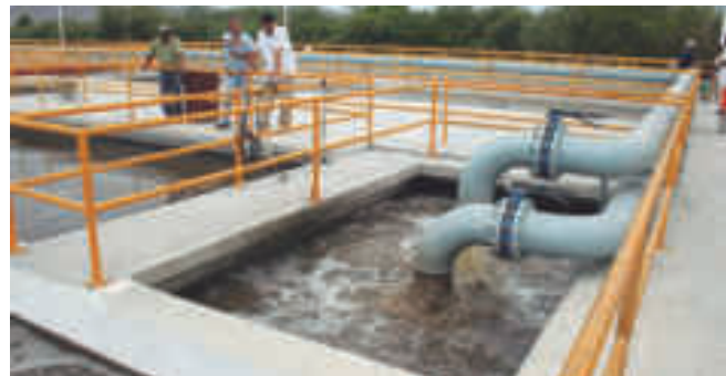
Planta de tratamiento de aguas residuales de la represa los Laureles, Honduras.
