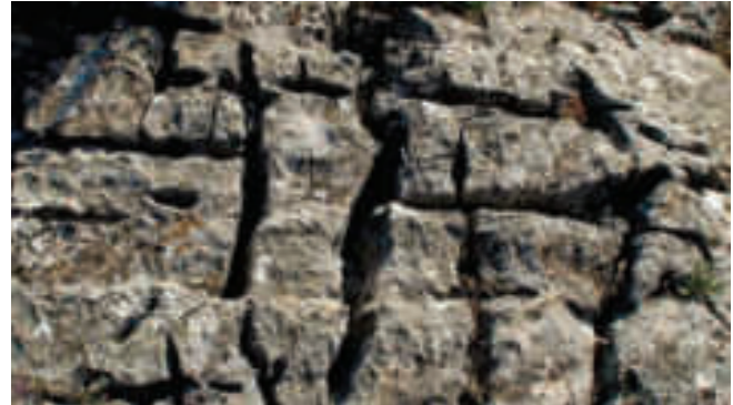
Efectos sufridos por las rocas debido al congelamiento del agua en las grietas
